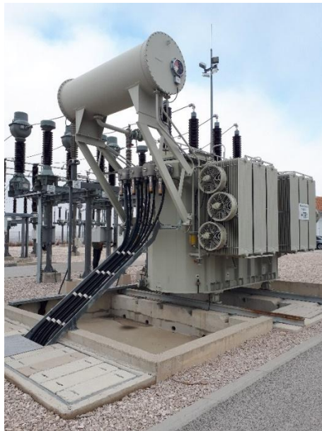
Slika 16 – Transformatorska stanica vjetroparka Danilo RP Global
