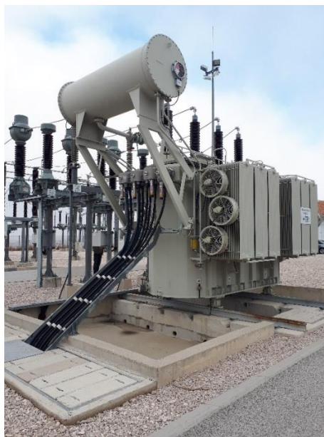
Slika 12 – Transformatorska stanica vjetroparka Danilo RP Global
